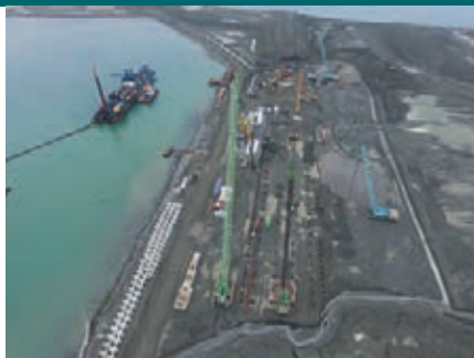
Vista aérea de la obra en el Terminal de Contenedores de Moin, en Costa Rica.
