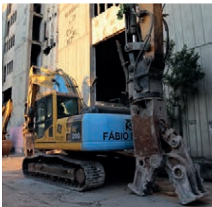
Fabio Bruno Construções, referencia en demoliciones en Brasil, realizó la operación en Río.
