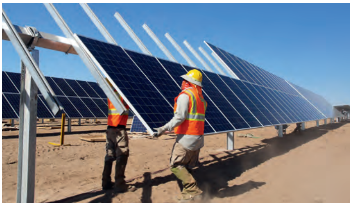
Se trata del proyecto Xoxocotla, que tendrá una capacidad de 70MWAC.
